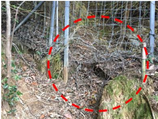
土砂の流出により裾部に隙間が発生
