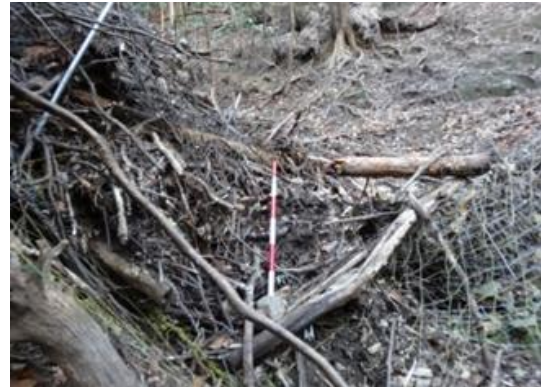
倒木等による柵の破損
